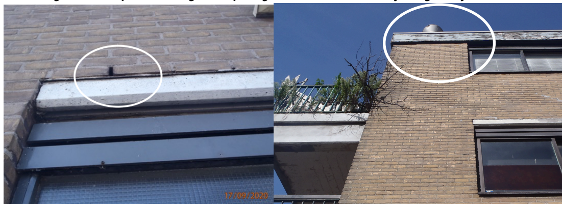
Afbeelding 11 en 12. Open stootvoegen en openingen onder de boeidelen zijn toegankelijk voor vleermuizen
