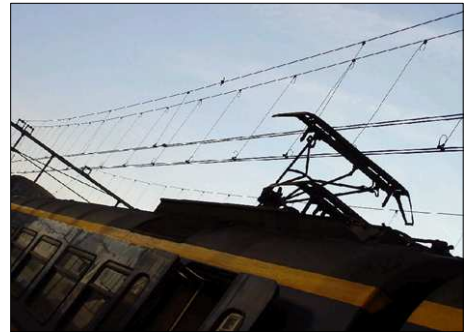
Figuur: Slijtende bovenleiding en pantograaf.
