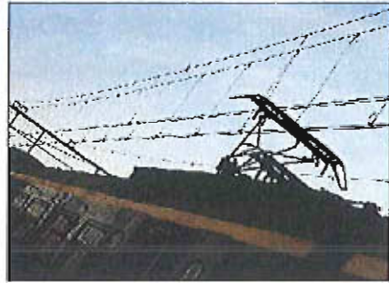
Figuur: Slijtende bovenleiding en pantograaf.
