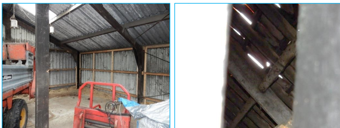
Foto's: Het ontbreken van dakbeschot en/ of -isolatie.
