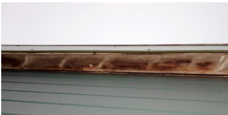
Foto 2 De lambrisering sluit goed aan, zodat er geen ruimte is voor vleermuizen om de spouw te bereiken
