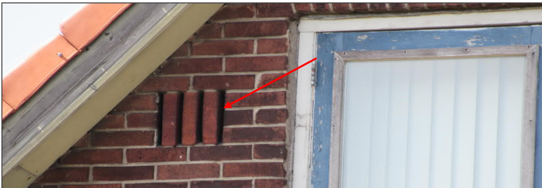
Figuur 7 Luchtroosters woning Hofgeesterweg 18A die toegang bieden tot de spouw.
