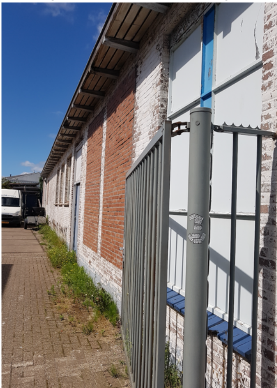
Afbeelding 7. In de muren ontbreken openingen en een spouw
